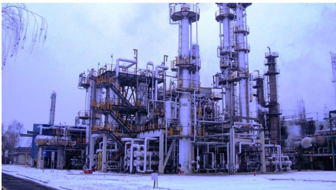
Postrojenje za hidrodesulfurizaciju FCC benzina
